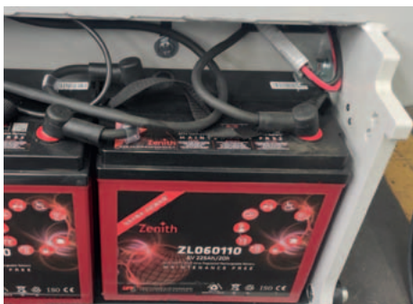
Vano batterie AGM
